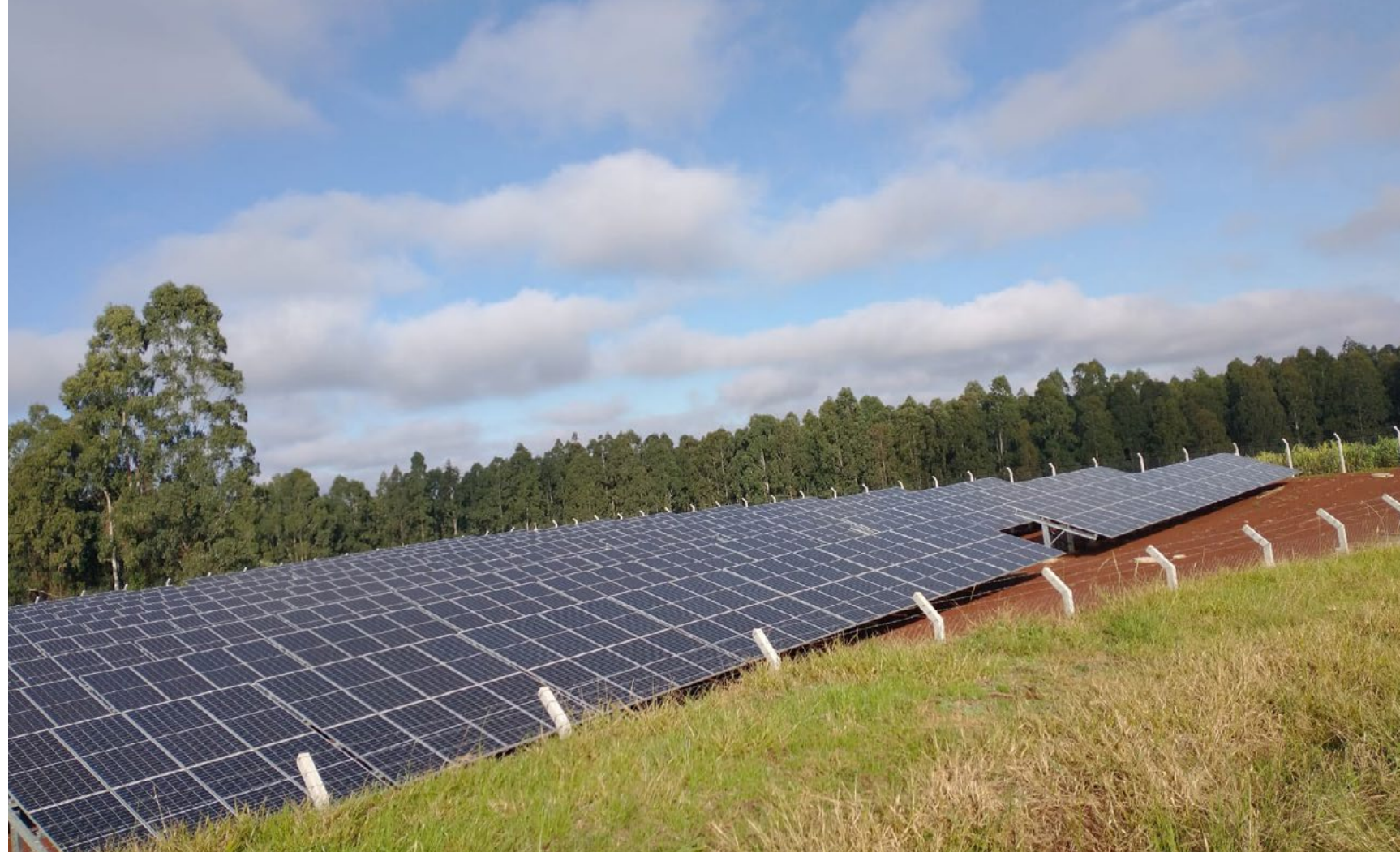
Usina Fotovoltaica do Campus Chapecó/SC Fonte: Secretaria Especial de Obras
