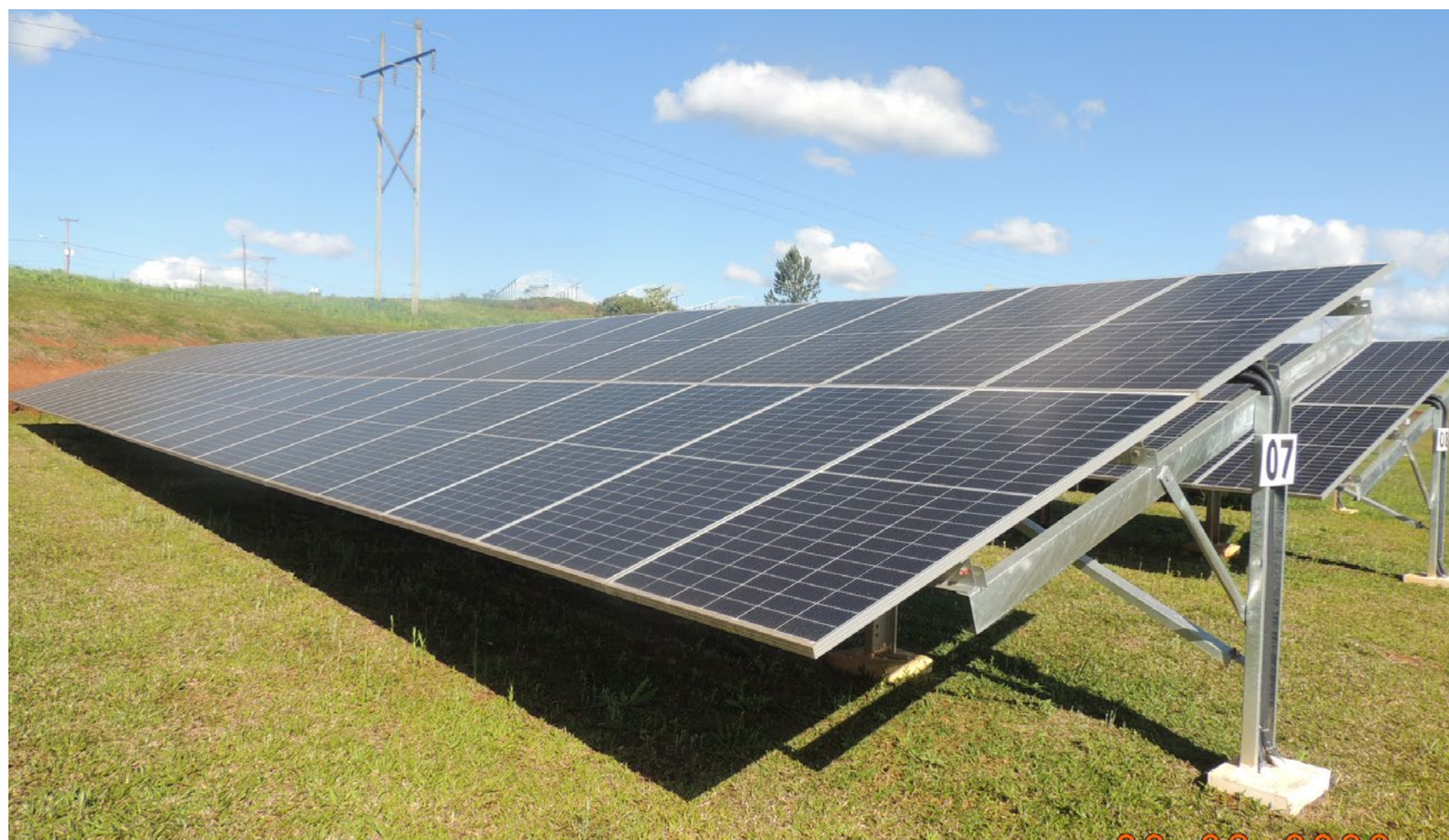
Usina Fotovoltaica do Campus Erechim/RS Fonte: Assessoria de Infraestrutura e Gestão Ambiental do Campus Erechim/RS
